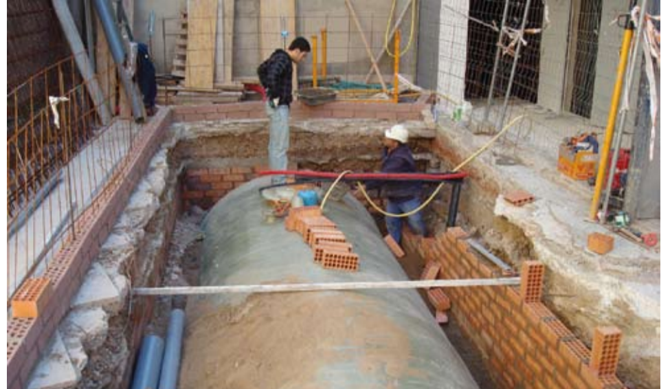
Un dipòsit de 28.000 litres d'aigua garantirà el sistema antiincendis
